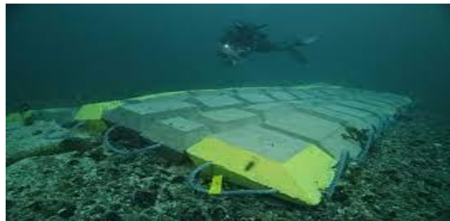
Protection par matelas béton
