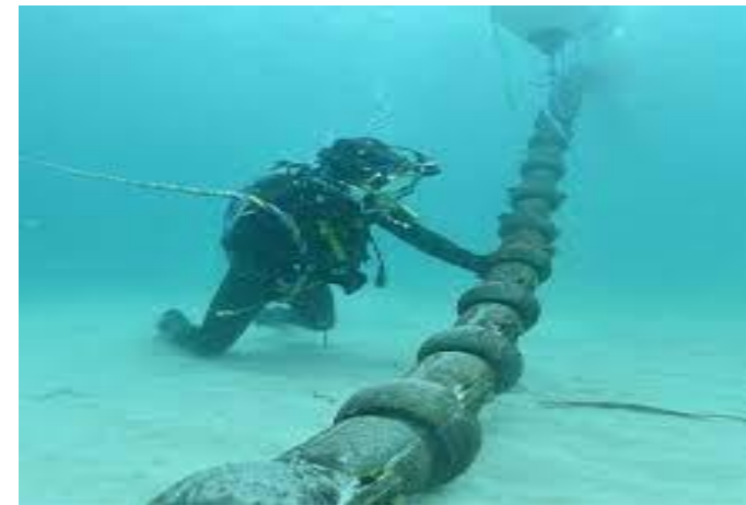
Câble protégé par des coques en fonte
